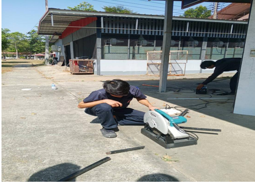
รูปภาพที่ 5 ทำการตัดเหล็กเพื่อทำการขึ้นโครง
