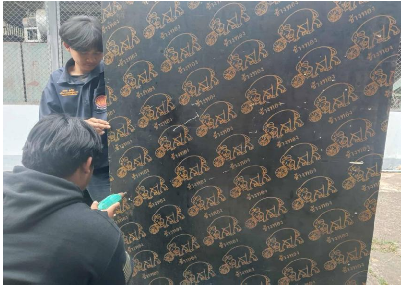
รูปภาพที่ 7 นำกระดานไม้อัดมาตัดเพื่อประกอบกับเหล็กที่เชื่อม
