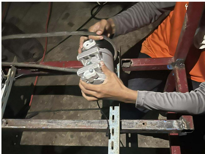
ภาพที่ 6 การติดตั้งมอเตอร์ไฟฟ้าและการทำฐานสไลด์เพื่อปรับความตึงสายพาน
